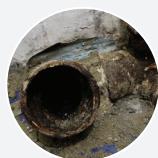
Tuberías y soldaduras
